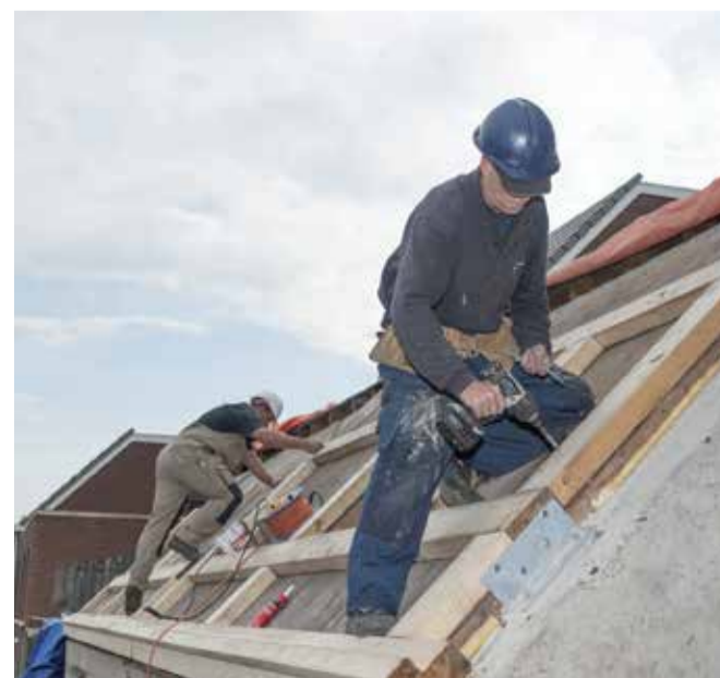
▲ De oude golfplaten zijn verwijderd; er wordt een raamwerk voor de isolatie opgebouwd.
