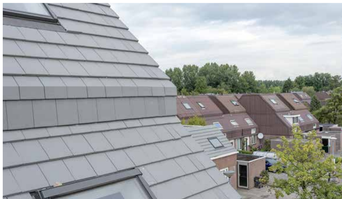
▲ De vernieuwde daken op de voorgrond met daarachter de daken met de oude asbesthoudende golfplaten.
