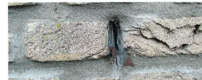
De vleermuis heeft bij gebouwen een voorkeur voor de spouwmuur. Om terugkeer te voorkomen is blokkeren van stootvoegen met een prop gaas voldoende.
